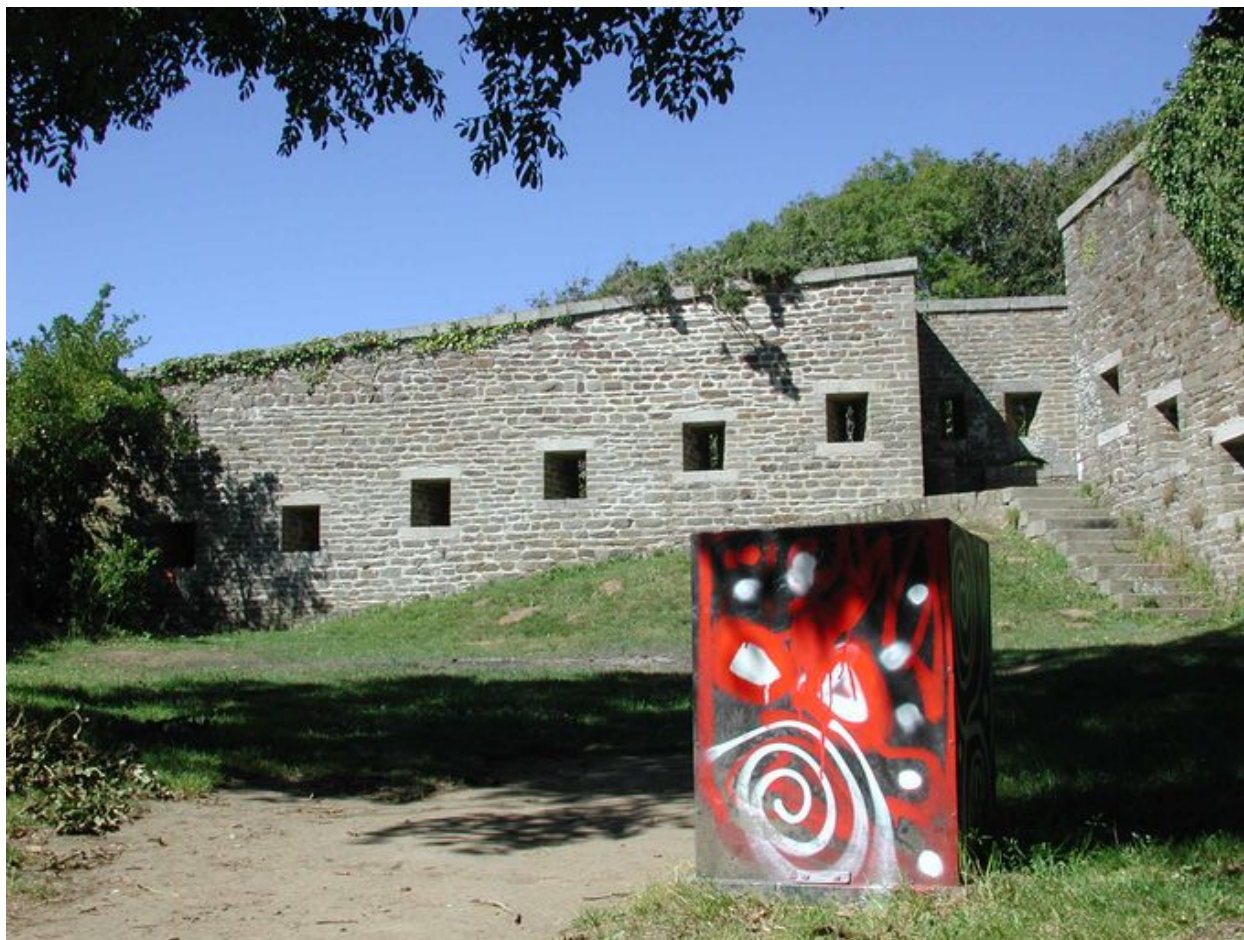
Vue du fort du Dellec : mur d'enceinte ouest percé de créneaux de fusillade. Bastionnet à mâchicoulis ou créneaux de pied
